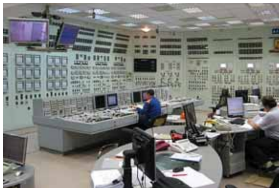
Блочный щит управления
